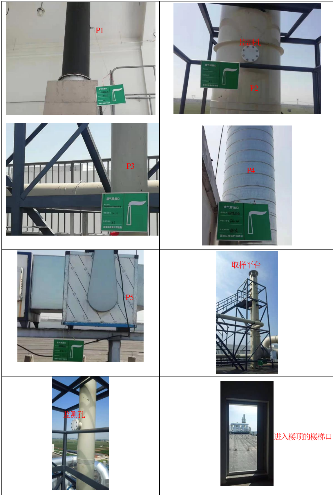
图 4-9 废气排气筒、采样平台及监测孔
