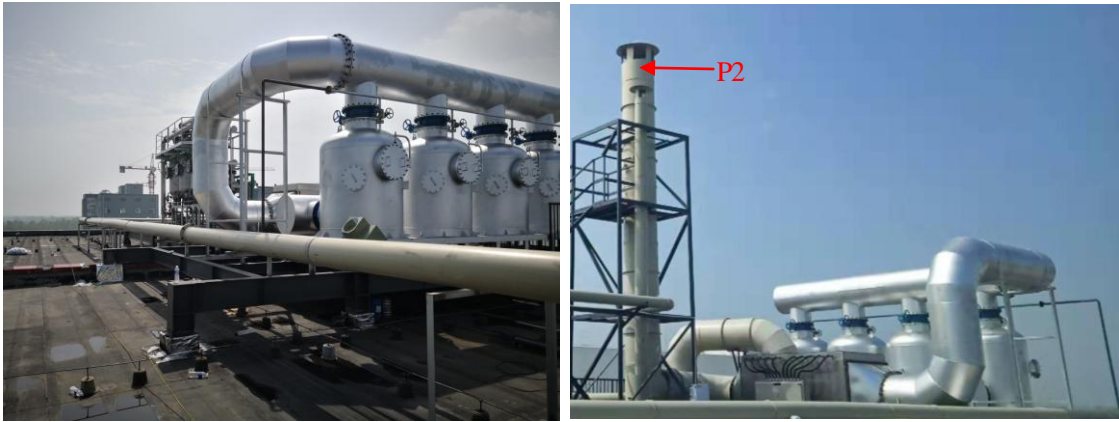
图 4-4 合成车间硫酸雾、非二氯甲烷有机废气及污水处理站废气处理装置
