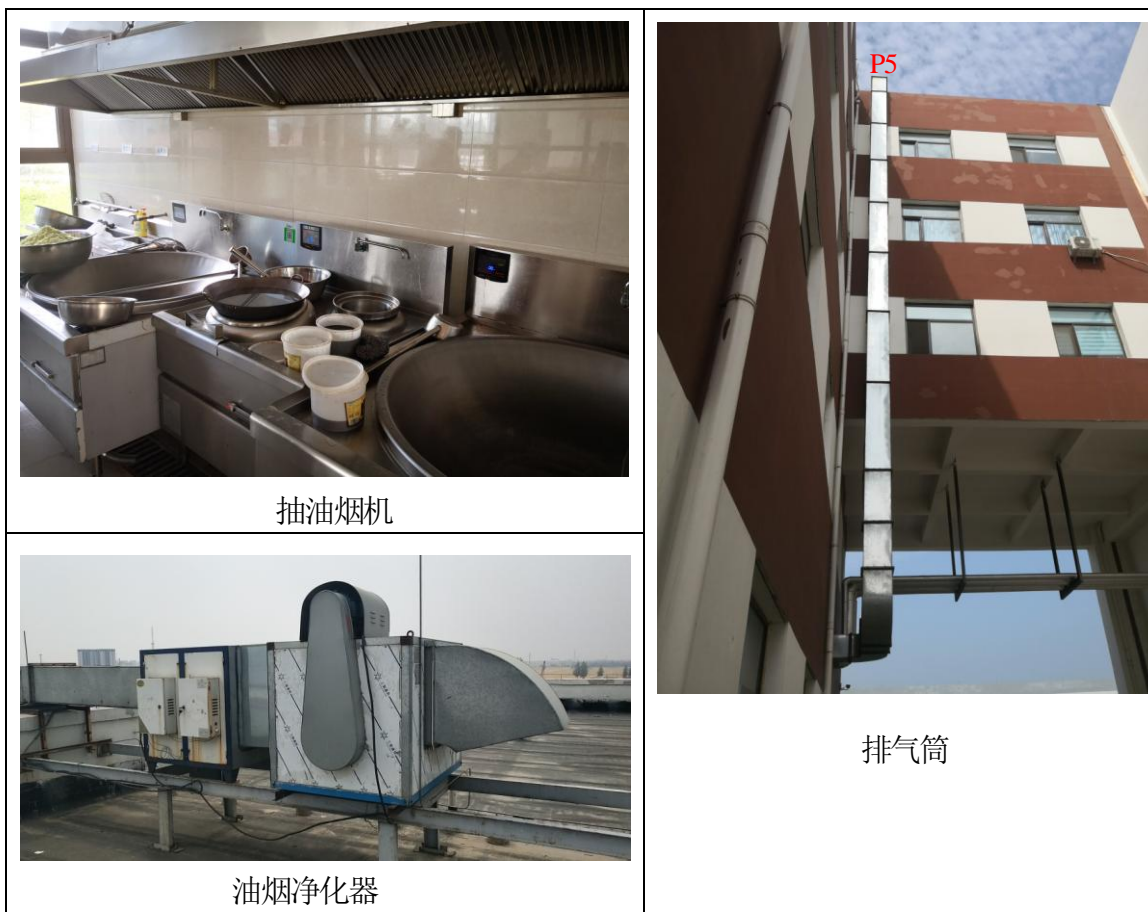
图 4-7 食堂油烟处理措施现场情况
