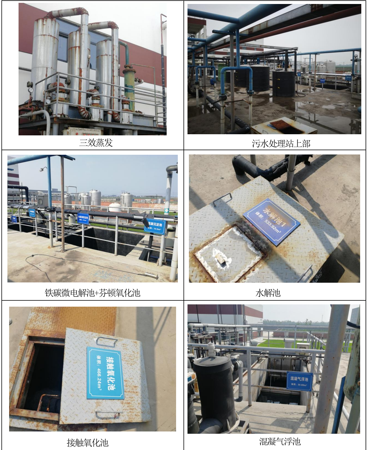
图 4-2 主要废水治理设施现场照片
