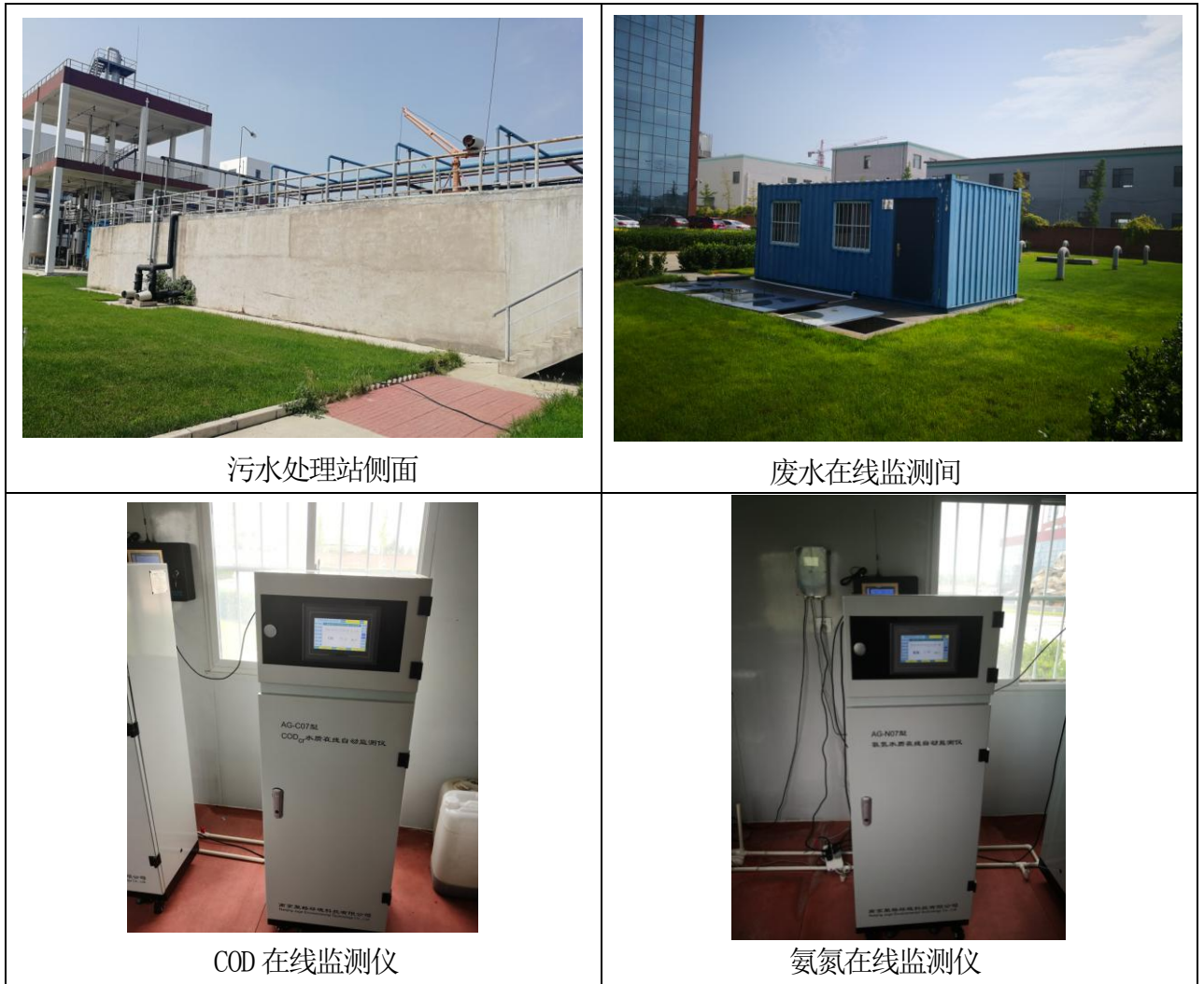
续图 4-2 主要废水治理设施现场照片
