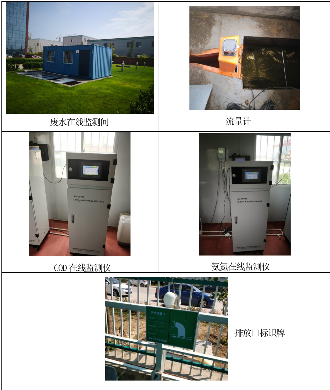
图 4-10 废水排放口主要设施
