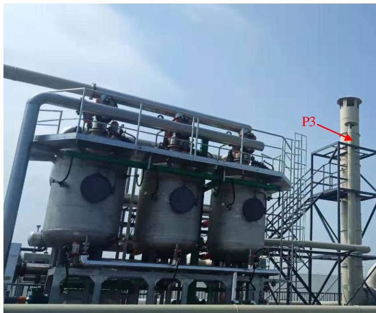
图4-3 含二氯甲烷有机废气处理装置
