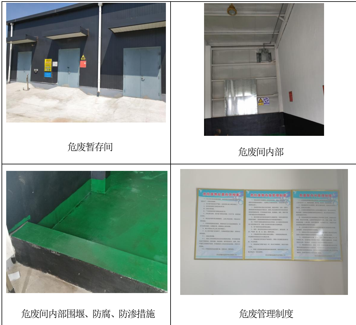
图 4-8 危废暂存间设置情况
